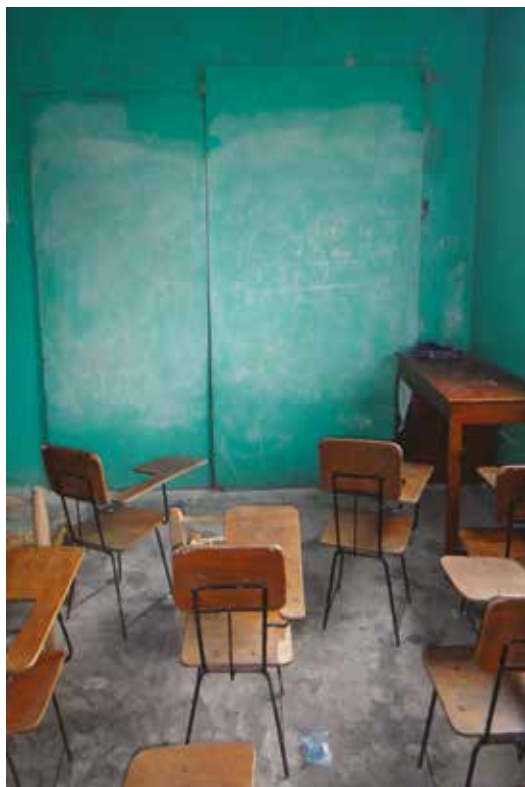
Une salle de classe en mauvais état en Haïti.
